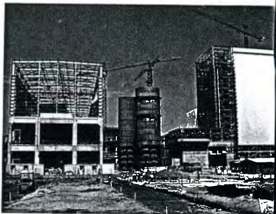
■ Vista de área de Blanqueo y Caldera Recuperadora.
